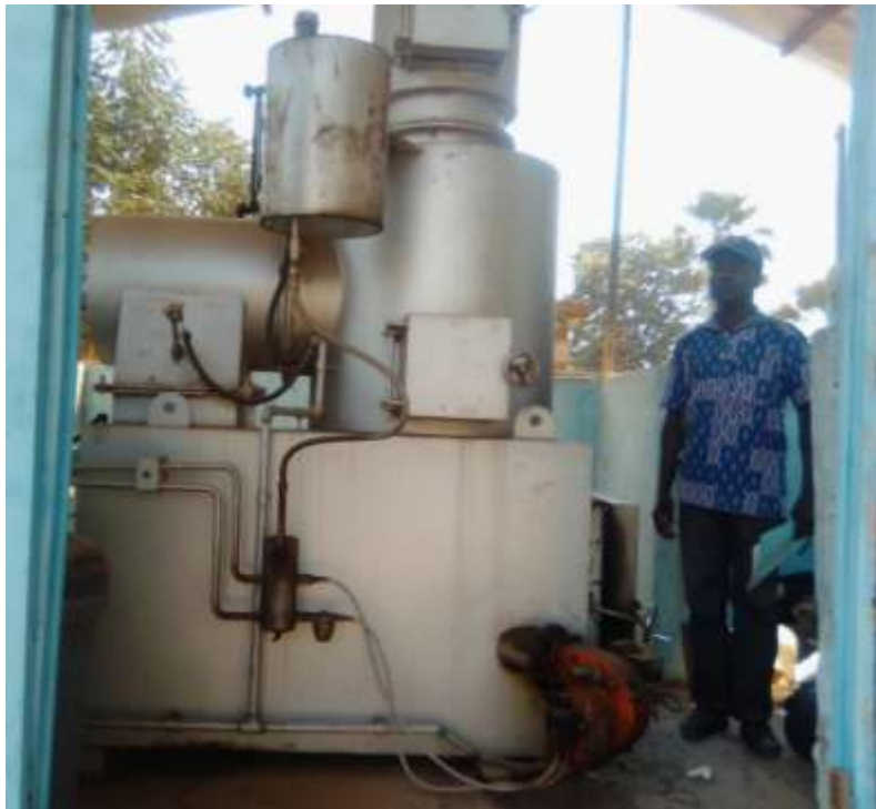
Photo 3 : Incinérateur moderne du CAT de Korhogo
