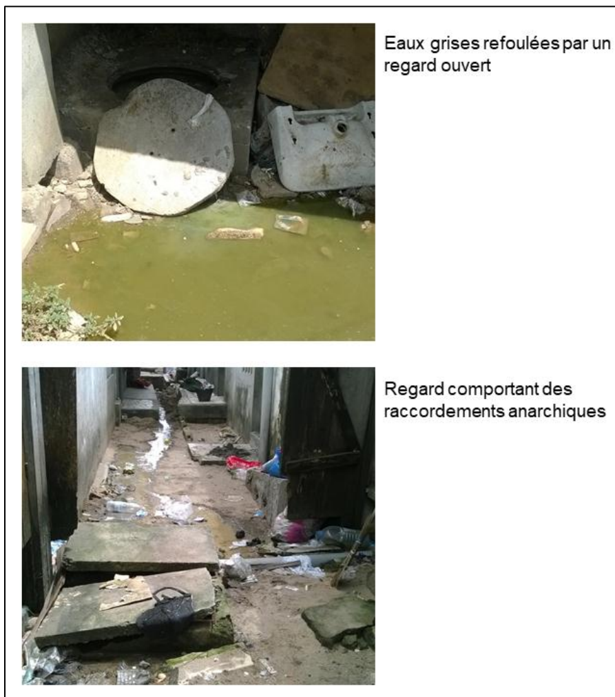
Figure 5 : Mauvais entretien et encombrement des regards par les ménages
