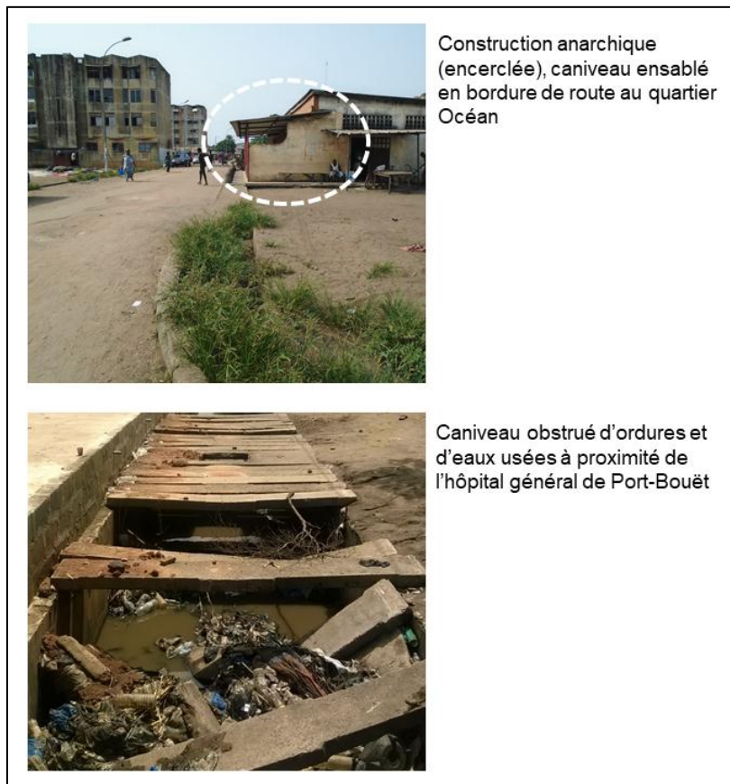
Figure 6 : Manque d'entretien et encombrement des caniveaux en bordure des routes.
