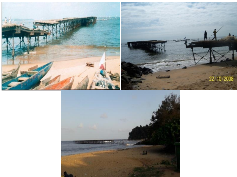
Planche 3 : Vues de la dégradation du wharf de Sassandra
