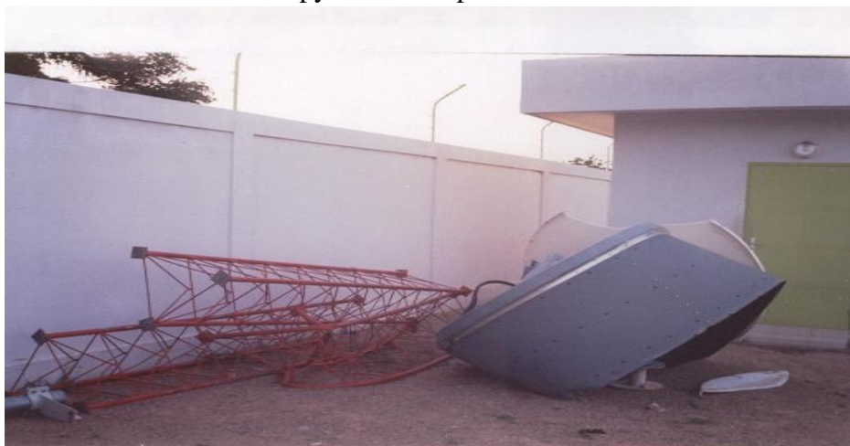
Photo 1. Destruction de pylône GSM par le vent à Karimama
