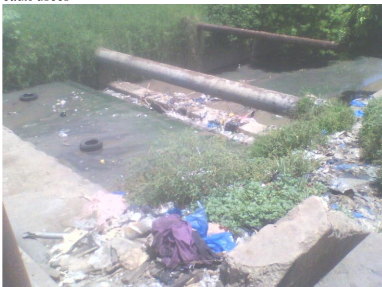
Photo 2 : Vue de déchets accumulés dans un caniveau d'évacuation des eaux usées
