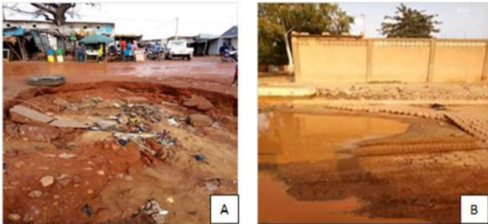
Photo 3 : Dégradation du réseau routier A : route RN11, et B : rue pavée au quartier Djaguindi
