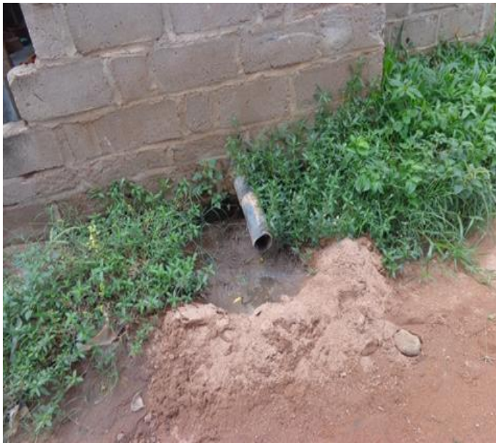
Photo 2 : Écoulement des eaux de toilette derrière la douche au quartier Miangabougou (Cliché de Traoré F., 2016)
