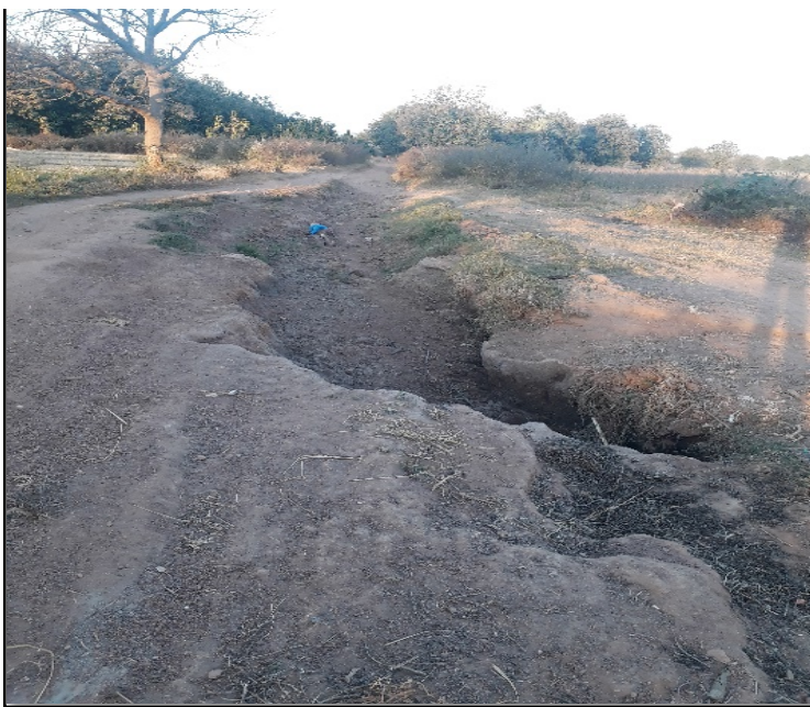
Photo 2 : Une piste dégradée dans la sous-préfecture de Lataha
