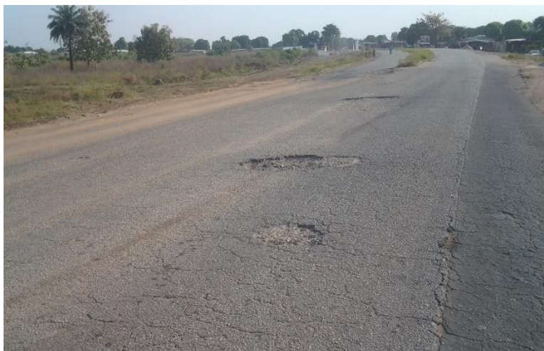
Photo 3 : voirie principale « la nationale A3 » dégradée à Tafiré
